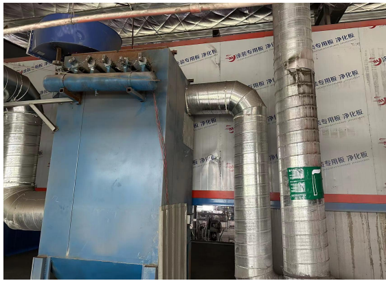
喷塑废气处理装置+排气筒
