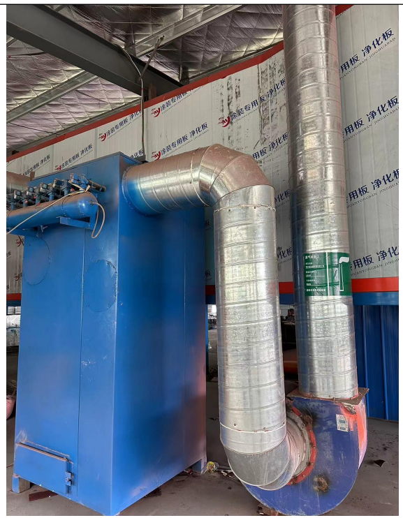
喷塑废气处理装置+排气筒
