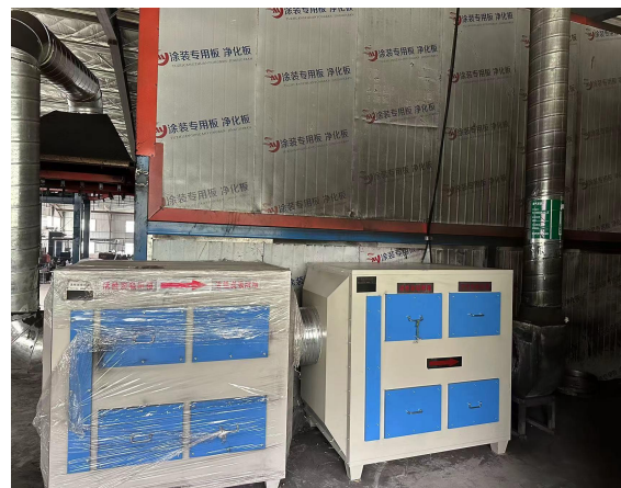
固化废气处理装置+排气筒
