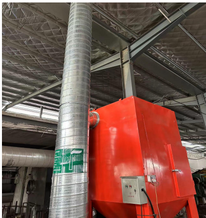
焊接打磨废气处理装置+排气筒
