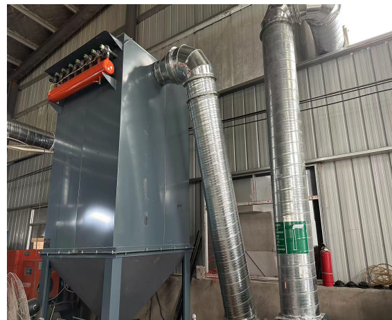
切割抛丸废气处理装置+排气筒
