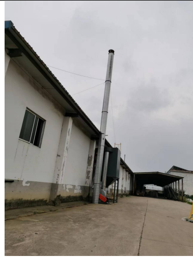
筛分废气处理设施及排气筒
