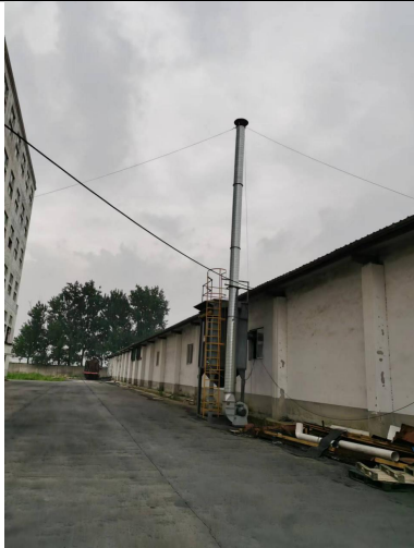
投料废气处理设施及排气筒
