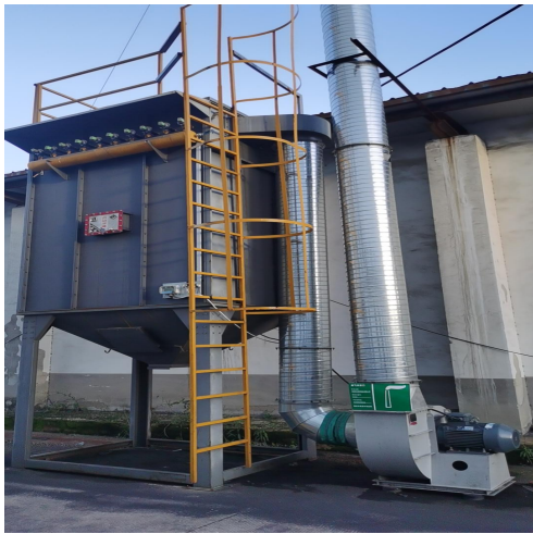
投料废气排口
